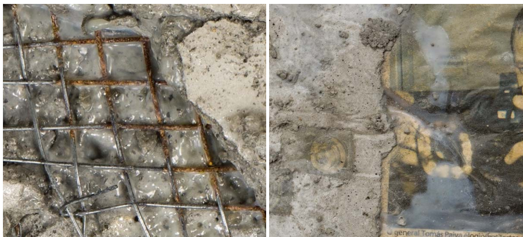
Figure 6 e 7. Prodotti di corrosione dell’armatura e strato di adesivo spesso sbiancato in corrispondenza dello strato cartaceo e cementizio.
