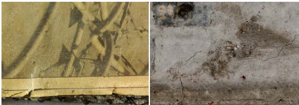
Figure 4 e 5. Lacerazioni dello strato cartaceo e fessurazioni del supporto cementizio.
